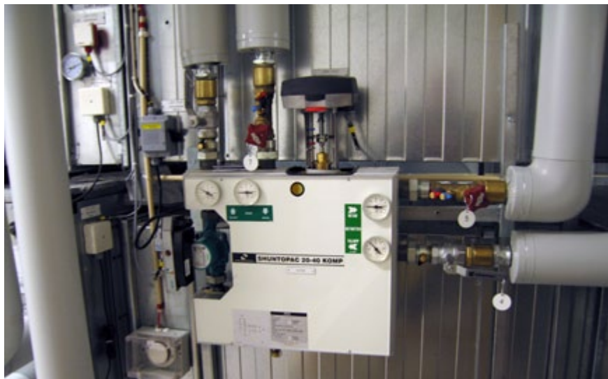
Teknikutrymme vid Lundbyskolan. Källa: Kommunfastigheter, Örebro.
